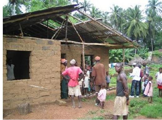
まずは、本格的な雨季が来る前に、屋根の完成に向けて始動。まずは測量。
